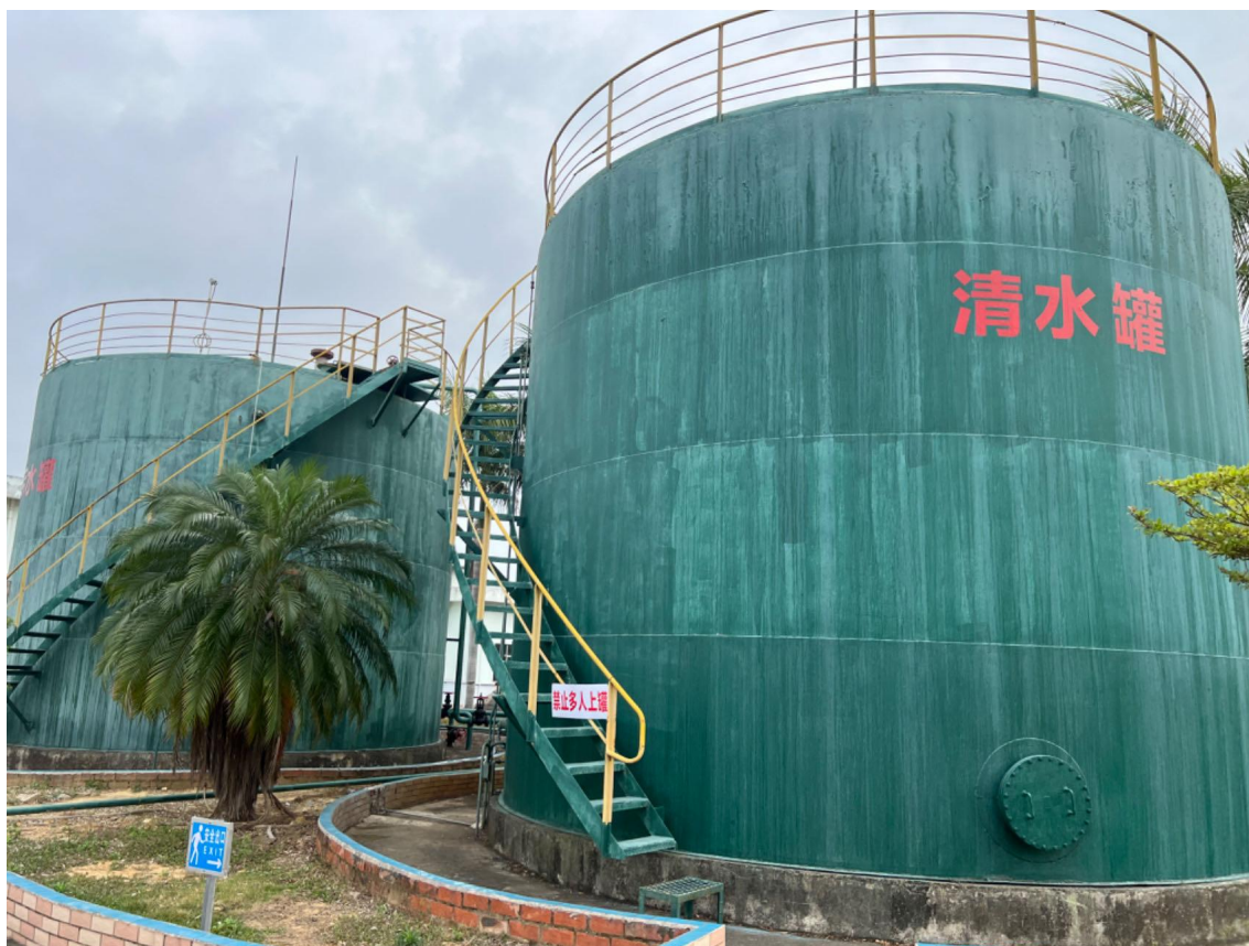
图 2.6-1 清水罐及污水罐
