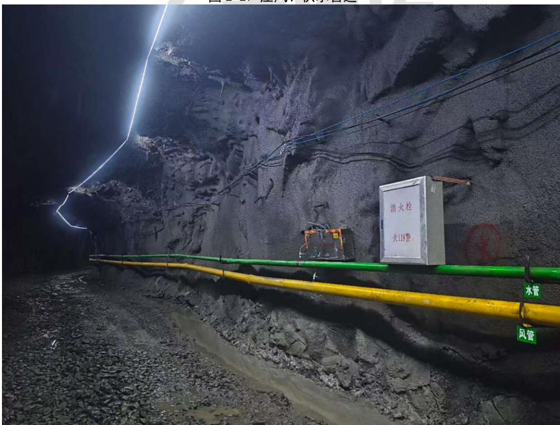
图 2-28 巷道内消火栓
