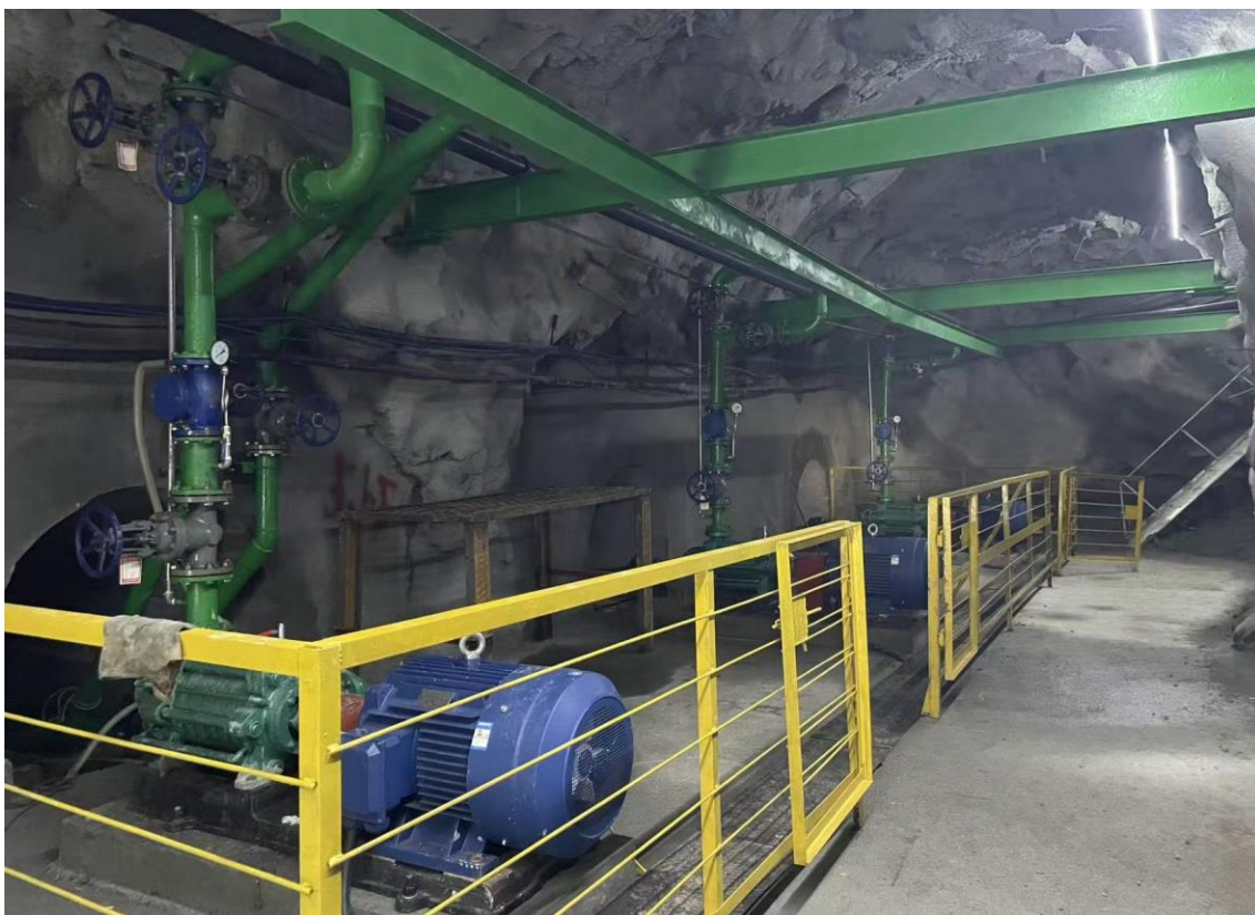
图 2-17 水泵房及水泵
