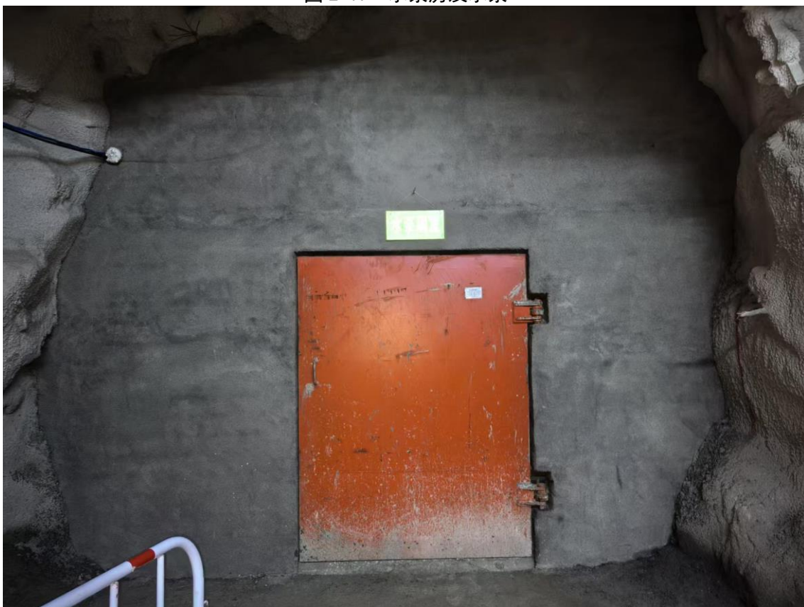
图 2-18 水泵房防水门
