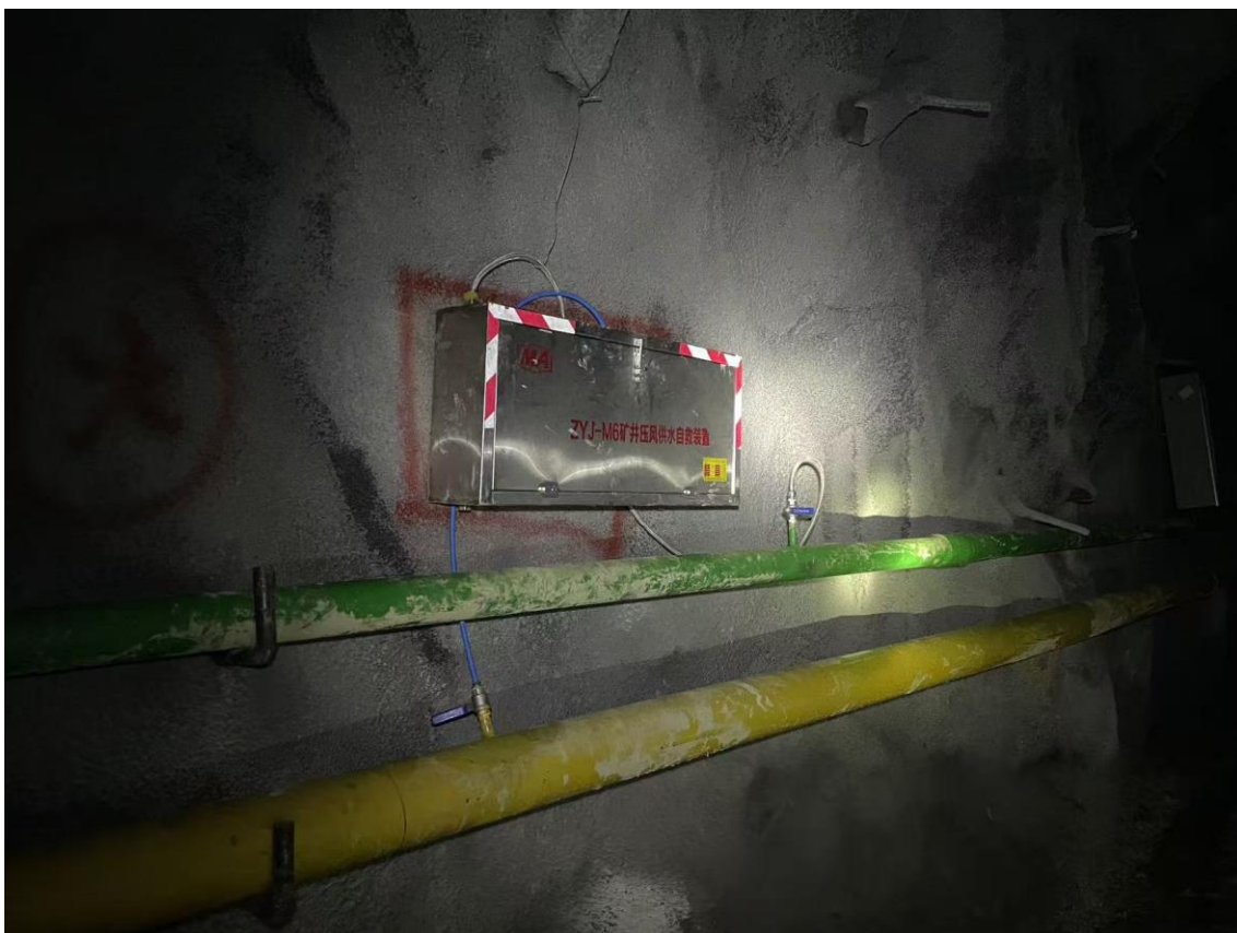
图 2-27 压风、供水管道
